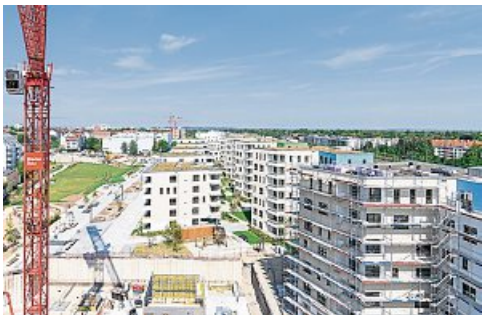
Das Bauen von Wohnungen wie hier in der Kuvertfabrik soll rascher gehen. F.: Schmidt
